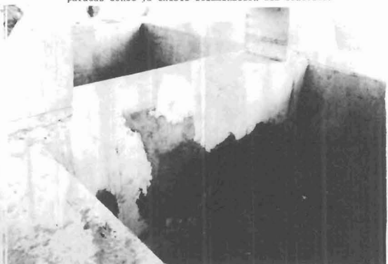
Foto 11.- Pila 7, vista por el lado interior de las vigas, en zonas de salpique. Obsérvese las zonas reparadas donde ya existe delaminación del concreto.
