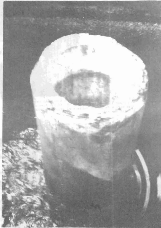
Foto 34.- Pilote, no estructural, situado en la pila 15 del puente. Observe que no está delaminado en la zona de oleaje y salpique.
