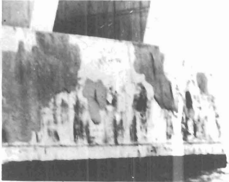
Foto 6.- Delaminación del concreto con cabillas expuestas en la pila (cabezal). Se nota claramente lo inadecuado de la reparación con delaminación del concreto en esas zonas.
