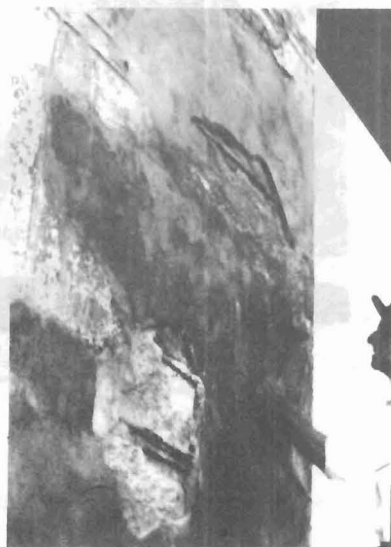
Foto 4.- Gran deterioro de un fuste de la pila 16. Zona ya reparada. Se muestra lo inadecuado de la reparación que acelera la velocidad de corrosión del refuerzo.
