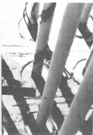
Foto 2.- Falla de los cables del Puente sobre el Lago de Maracaibo, debido a corrosión en el sitio de anclaje de éstos (tapón de madera).
