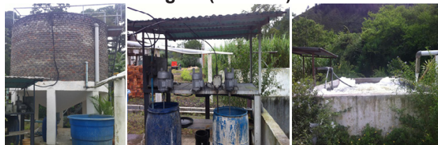
FIGURA 3. Tanque físico-químico cónico (izquierda), Sistema de preparación y dosificación de soluciones (centro) y Tanque de aireación del reactor biológico (derecha).
